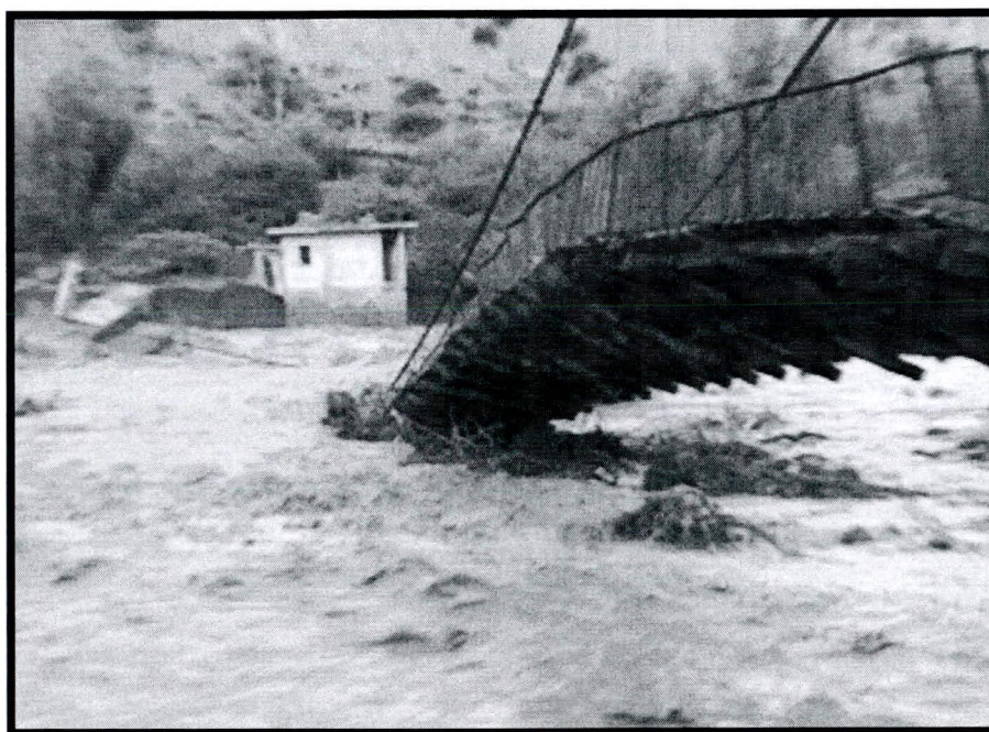
Fotografía 03: Puente Santa Rosa, completamente deteriorado.
