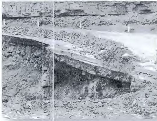
Solicitamos la pronta ayuda y reconstrucción de sus principales vías de acceso de dicho distrito.
