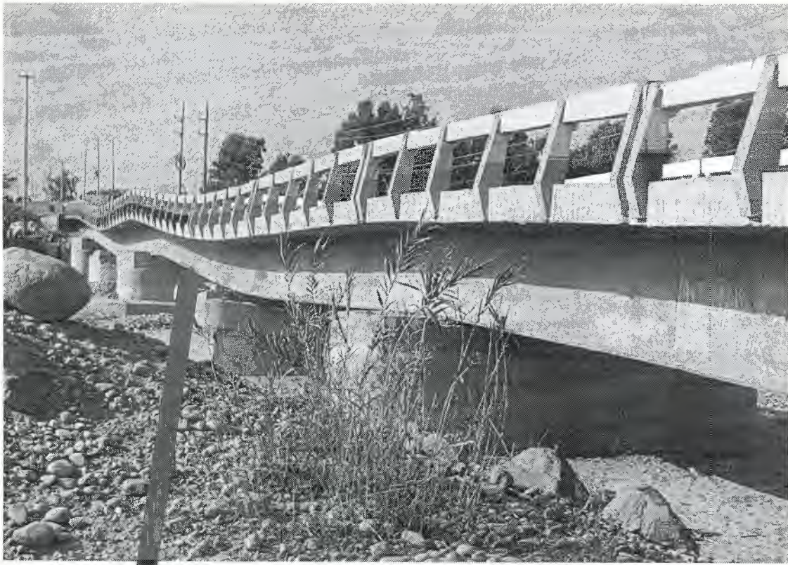
En esta foto se aprecia el hundimiento o asentamiento del puente CHAMORRO
