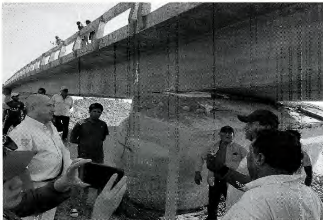
En esta foto se aprecia la inclinación del cimiento que sirve de base, los ciudadanos piden la intervención de su representante.
